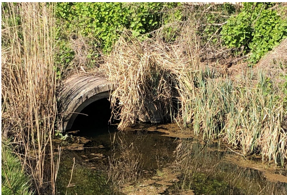
Figur 2-3: ROS-185 er en 8 meter lang rørledning.
