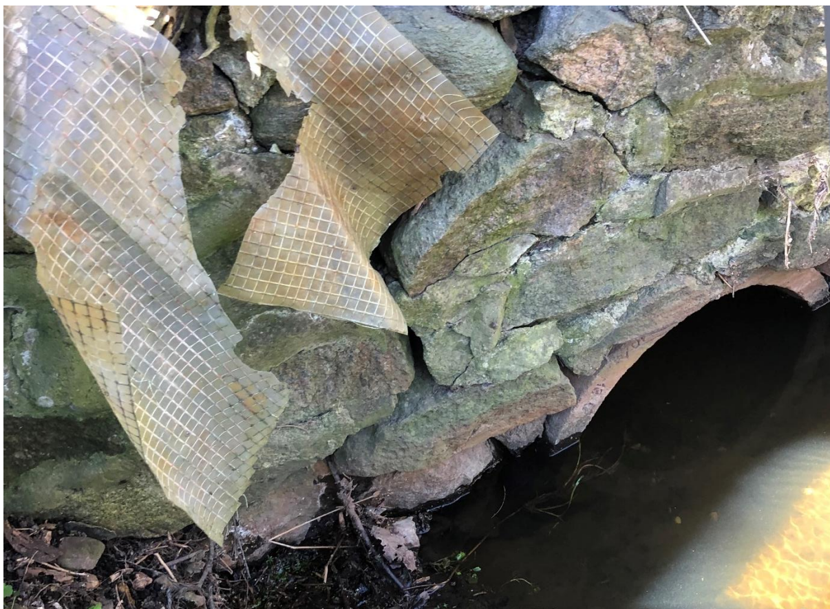
Figur 2-4 Indløbsbygværket under A6 er i meget dårlig stand og i risiko for sammenstyrtning.
